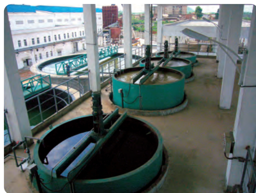
湖南桂阳银星100kt/a铅冶炼工程废酸废水处理站
