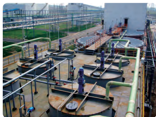
中原黄金冶炼厂铜冶炼系统废酸废水处理站
