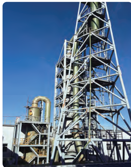
▶ 内蒙古兴安铜锌渣处理烟气制酸工程 单转单吸+尾气处理
