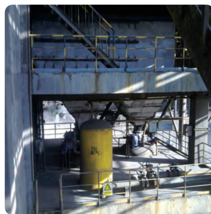
➤ 气力输送装置
